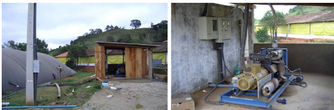
Figura 3.7 - Conjunto motor/gerador não conectado à rede.
